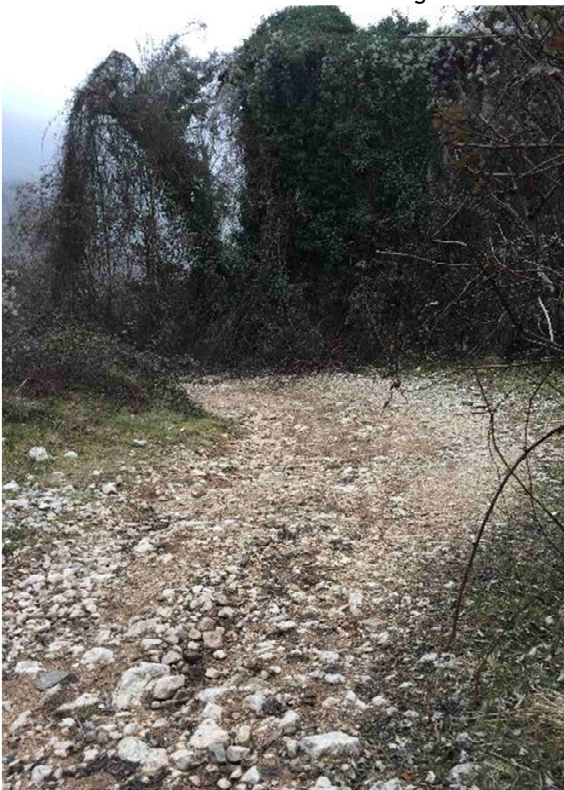
Intervento 1: Erosione prima dei ruderi di Segrane
