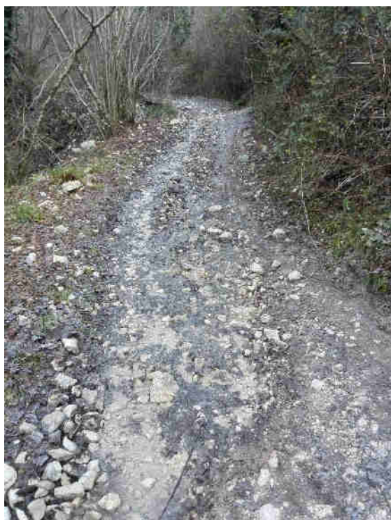
Intervento 1: L'acqua che dall'impluvio invade la carreggiata
