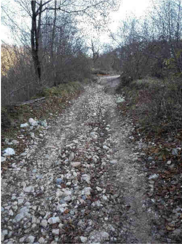
Intervento 2: Erosione lungo la carreggiata
