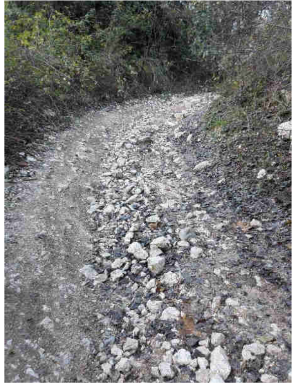
Intervento 1: Erosione prima dei ruderi di Segrane
