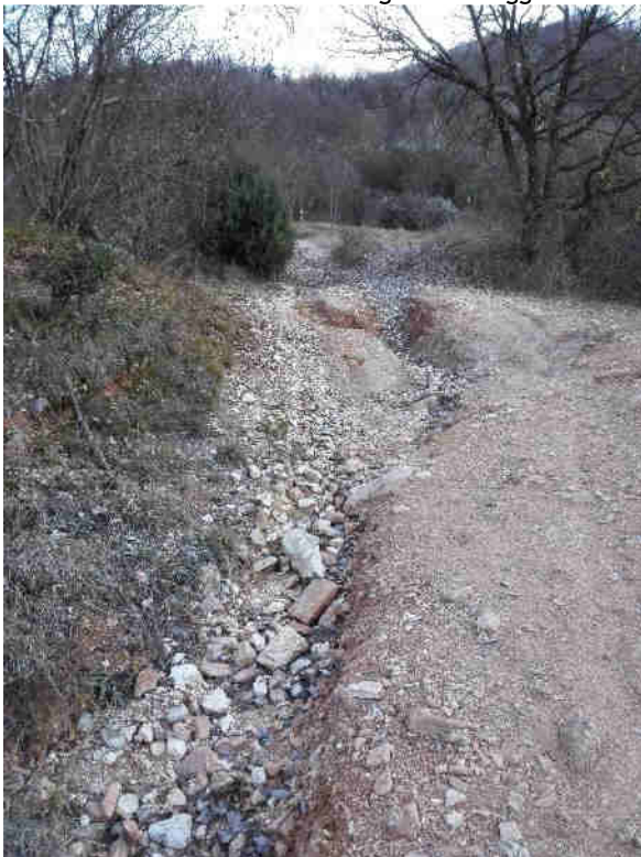
Intervento 2: Erosione lungo la carreggiata
