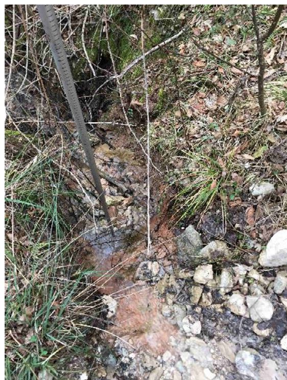
Intervento 1: Erosione della scarpata di valle nel punto di uscita dell'acqua dalla carreggiata
