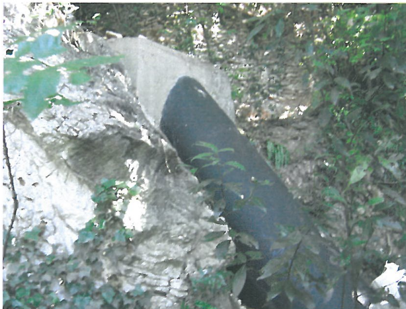
Condotta fognaria in alveo. Tale manufatto segue il corso del fosso da Pulciano allo sbocco a lago.
