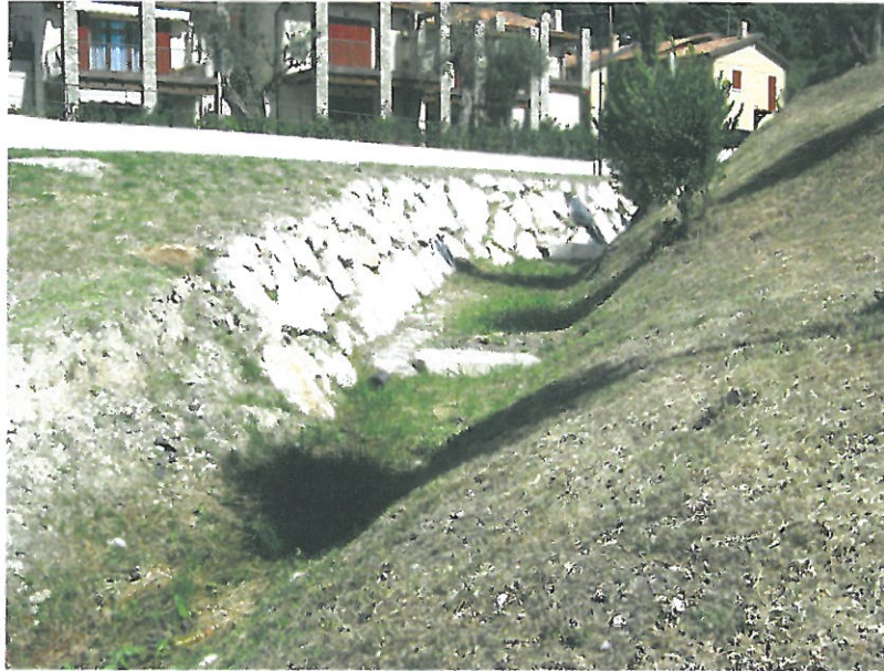
Opera radente realizzata in seno ad una lottizzazione situata poco a valle di Pulciano.
