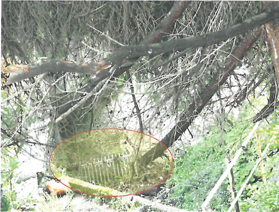
Vista della griglia a protezione del tratto sotterraneo in prossimità di Via Piè della Costa.
